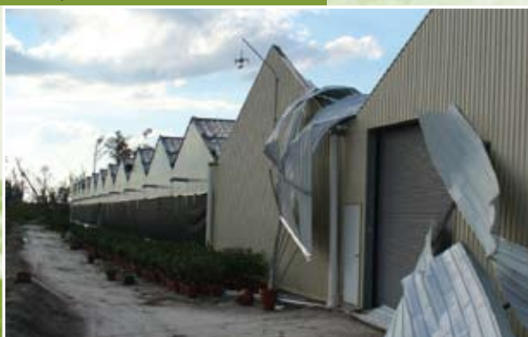
Estructuras metálicas (no Cravo) a la derecha, mostrando daños significativos
